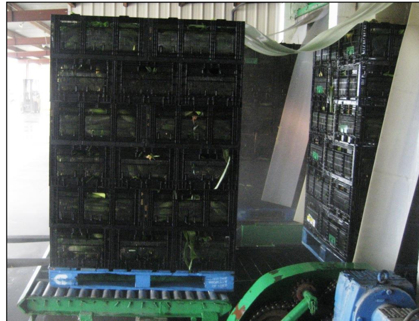
Refrigeração a água
